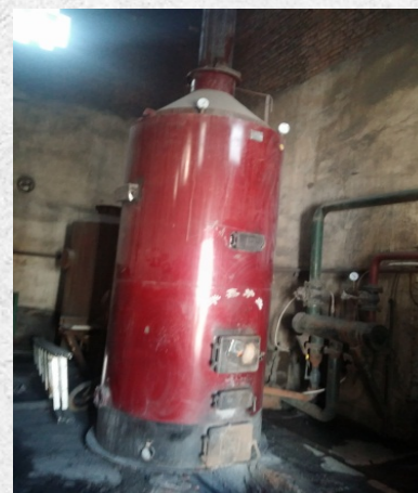
中国製縦型ボイラ 10%
