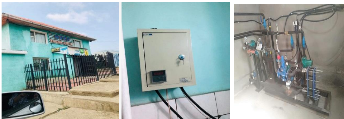
Зураг 1. Цахилгаан халаалтад холбосон байдал
